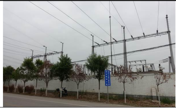
庄里110kV变电站进线处
