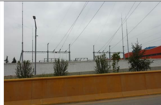
庄北110kV变电站出线处
