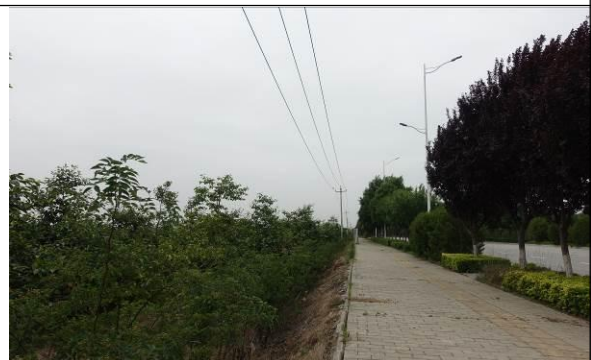
架空线路通过环城路段
